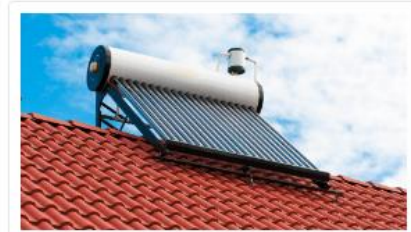
Sistemas Solares Térmicos: Una tecnología clave para la descarbonización energética
